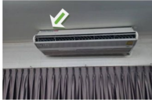
(เปลี่ยนเครื่องปรับอากาศใช้ R410A)
