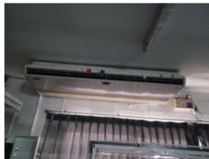
(เครื่องปรับอากาศเดิมใช้ R22)
